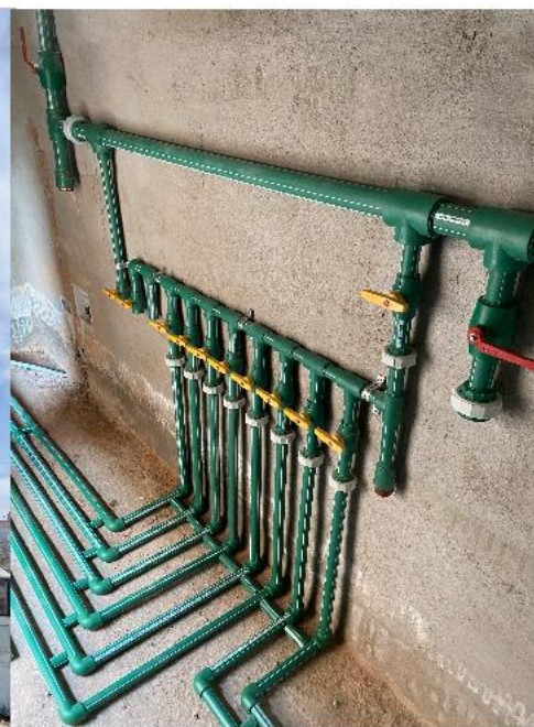
provisión de agua
