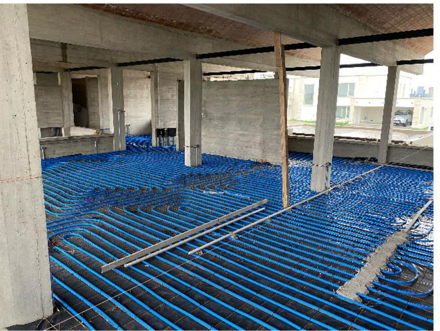
calefacción por piso radiante
