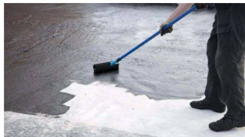
Figura 8. Emulsión asfáltica aplicada en techo.
