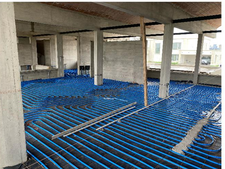
calefacción por piso radiante
