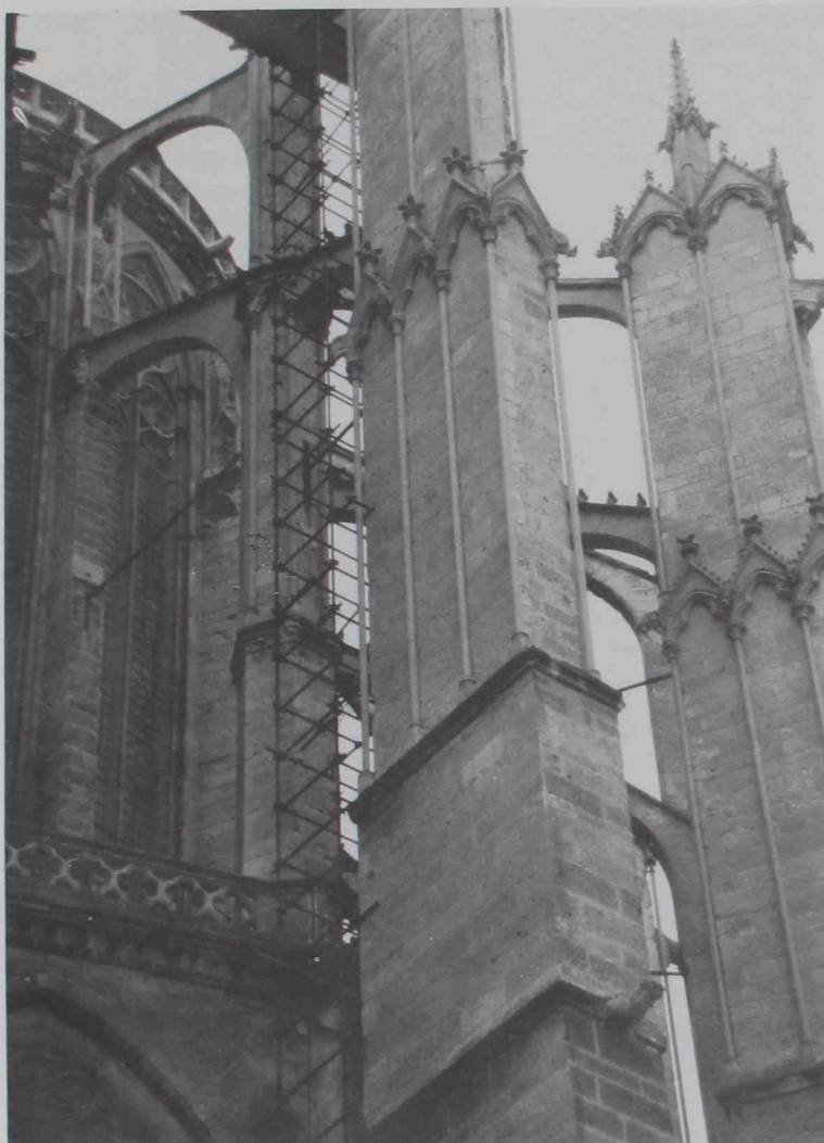
14. Su esbelta estructura de arbotantes y contrafuertes cedió, según Viollet, porque las esbeltas columnillas de una sola pieza produjeron desequilibrios en los arbotantes al descender los muros vecinos por la retracción de las juntas entre sillares.
