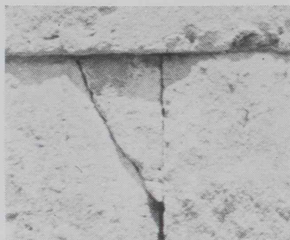
12. El contacto directo entre los sillares de las fábricas produce esfuerzos localizados excesivos y se desprenden lascas o se rompen las aristas, como en este muro pompeyano.
