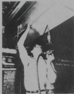
13. En todos los casos, la ejecución de fijaciones en posturas difíciles o en lugares inaccesibles puede poner en peligro la calidad de las mismas.
