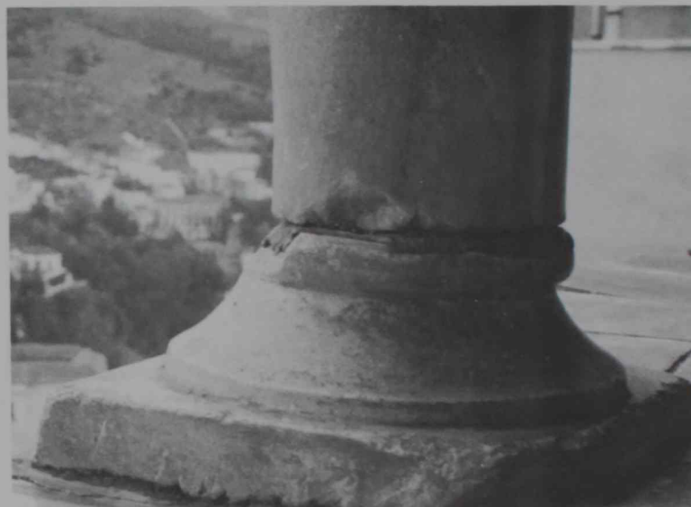
14. El adelgazamiento de la lámina de plomo ha provocado desportillamientos en este pilarcillo del llamado Mirador de la Reina de la Alhambra de Granada.
