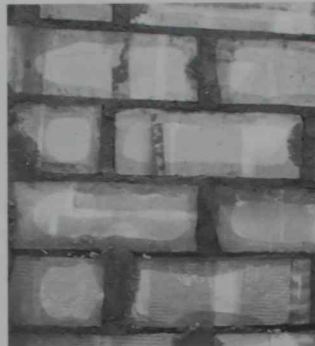
14. Las fábricas insuficientemente húmedas, como la de la figura, absorben el agua del mortero e impiden su correcto fraguado.
