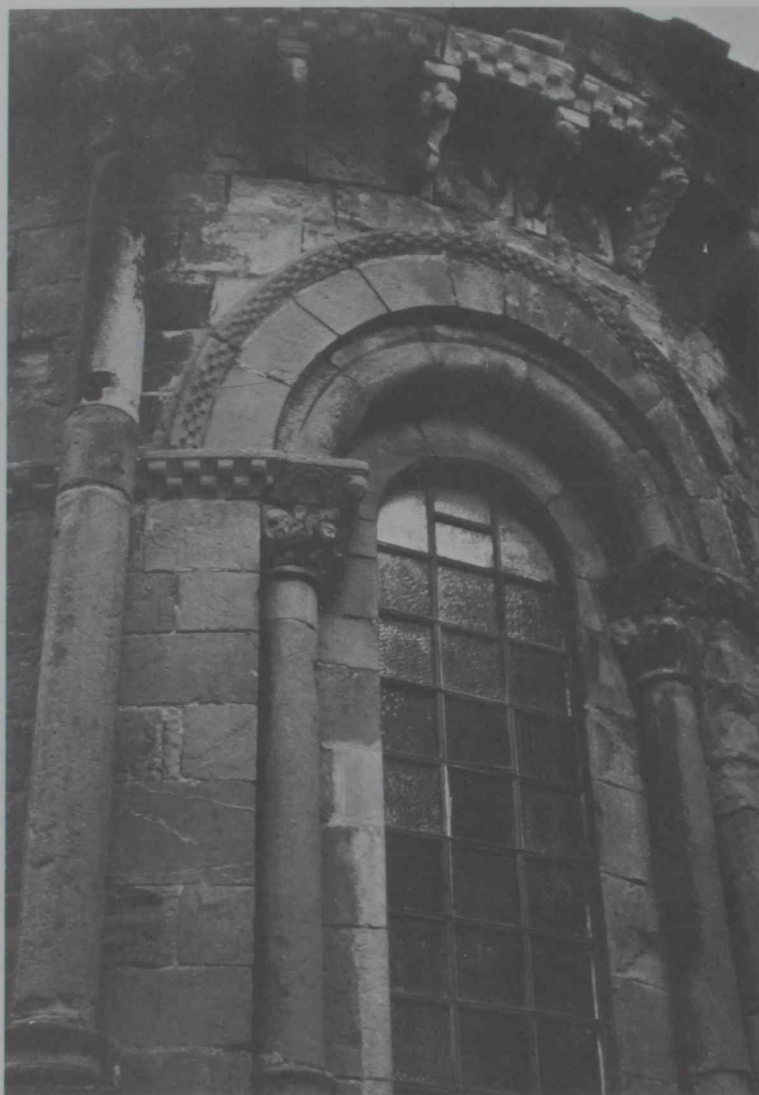
12. Las ventanas del ábside de la catedral de Jaca señalan un defecto común en las construcciones gótica y románica: el uso de elementos verticales de una sola pieza, sin juntas, los conduce a asumir una carga muy superior a la que reciben los elementos adyacentes, que tienen numerosas juntas y, por tanto, mayor capacidad de retracción.
