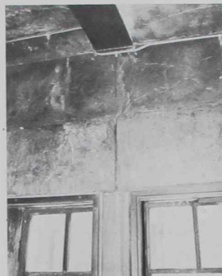
6. Las cargas concentradas sobre elementos continuos producen deformaciones diferenciales. Si el reparto de éstas es tal que no se excede la capacidad del material para soportar esfuerzos cortantes, las consecuencias no serán graves; de otro modo, aparecerán desórdenes como los que muestran algunos muros del Palacio Güell, estudiado por F. Mañá y R. Bellmunt.
