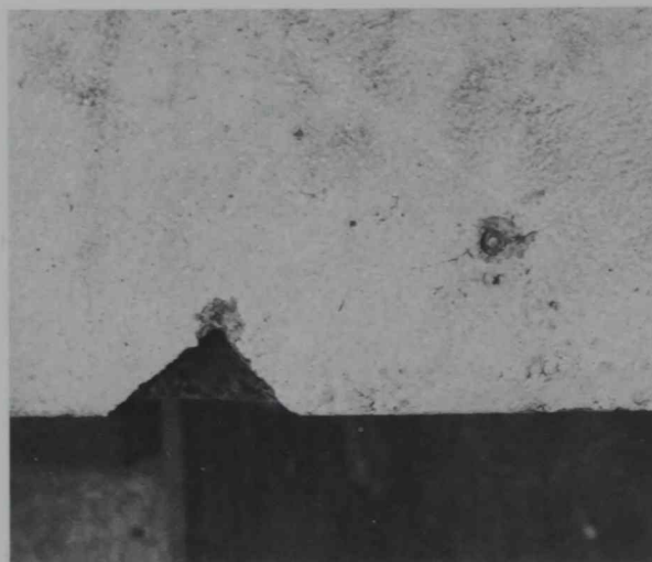
14. Cualquier fijación supone la aparición de esfuerzos localizados. Cuando dos fijaciones están demasiado cerca entre sí o alguna de ellas se acerca a un borde o bien a otro tipo de discontinuidad, pueden producirse desperfectos como el de la figura.
