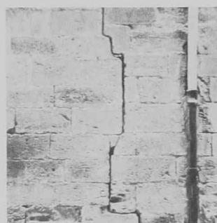
4. El muro más reciente, el de la izquierda de esta fachada de la catedral de Orihuela, fue asentándose al recibir sus cargas, mientras que el de la derecha, más antiguo, ya estaba comprimido y asentado. La adaraja prevista fue incapaz de transmitir el peso que le correspondía, y se quebró el sillar superior. Serrallach aconsejaba dejar un vacío en ese tendel para permitir el asiento del muro joven.
