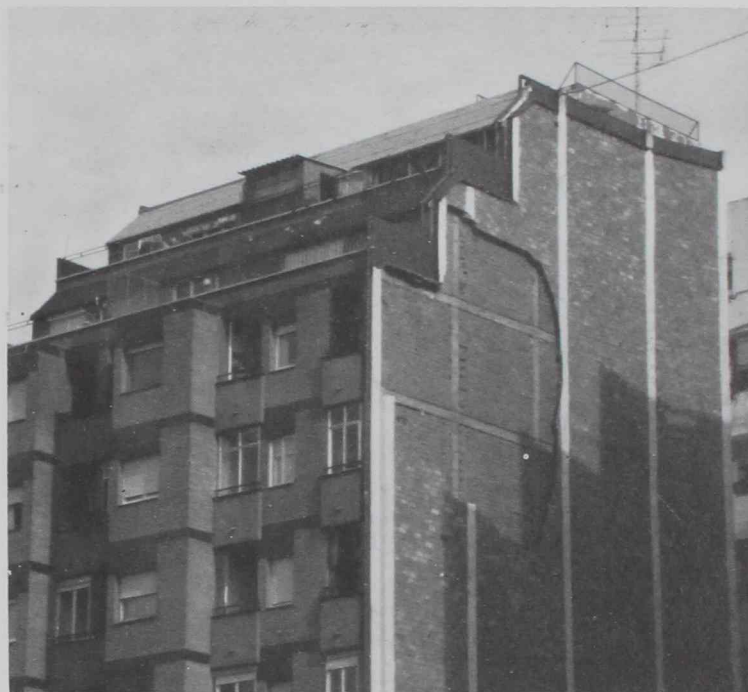
3. Cuando un elemento constructivo ve imposibilitada su deformación térmica por estar contenido rigidamente entre elementos más resistentes, es frecuente que se rompa, como este tabique pluvial barcelonés. El tabique medianero es un virtuosismo catalán que exige la ventilación de la cámara para evitar que se eleve demasiado la temperatura, los lienzos no excesivamente grandes, los apoyos sobre pilastras relativamente elásticos y, sobre todo, la plasticidad del tradicional mortero de cal.
