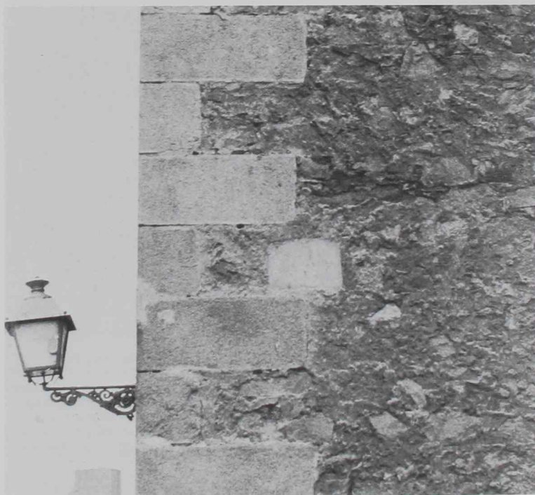
8. La diferencia de módulos de elasticidad entre los materiales que forman parte del mismo muro puede llevar a concentraciones de cargas en el más rígido o a la desolidarización de los dos elementos que sufren diferente deformación. En esta esquina de la Iglesia de Sarrià, en Barcelona, la mampostería busca una mejor trabazón con la sillería insertando piedras de mayor tamaño en los puntos donde es previsible la rotura de la fábrica de mampostería, incrementando así el módulo de elasticidad y la resistencia de esta última en su unión con la primera.
