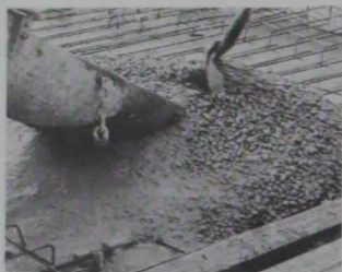
6. Uno de los puntos críticos de la puesta en obra del hormigón es la disgregación de sus componentes por mal transporte, vertido o vibrado. En la figura se aprecia la falta de lechada delante de la canaleta y su exceso detrás.
