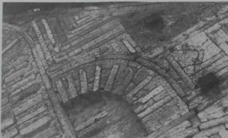
16. La prodigiosa artesanía de esta albañilería bizantina se apoya en el gran espesor de las juntas de mortero. Esta fábrica, especie de aglomerado de piezas cerámicas, sufre las consecuencias de la retracción del aglomerante.
