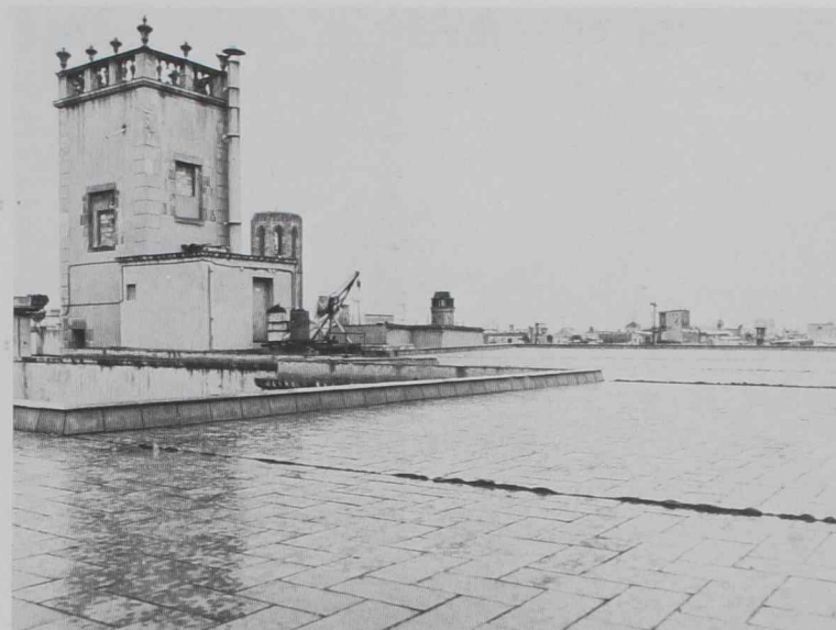
8. Esta imagen de la reciente cubierta del Palacio de la Virreina de Barcelona demuestra la importancia de los movimientos de las azoteas, incluso las de cerámica, como se puede comprobar por la expulsión del betón con que, defectuosamente, se intentaron llenar sus juntas.
