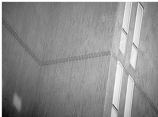
Paramentos planos revestidos con el mismo tipo de plaqueta, con una junta de dilatación del propio revestimiento.
