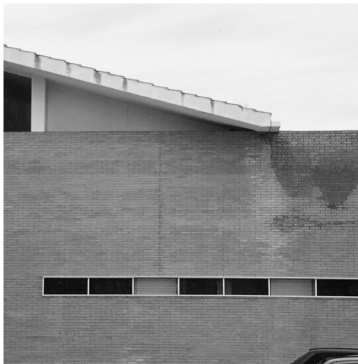
Demostración clara de los efectos positivos de la protección de las fachadas por las cubiertas. En la parte no protegida, además de la humedad de la lluvia reciente, se advierten las manchas blanquecinas de las eflorescencias.
