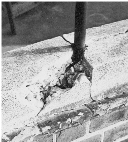
Rotura de una pieza de la albardilla de un muro de cerca por corrosión de la parte de la pieza de acero empotrada en ella.
