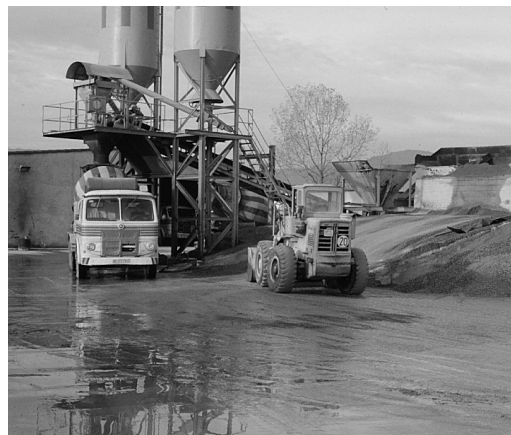
Central de producción de hormigón.
