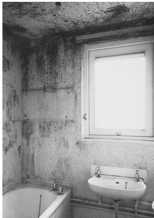
Efectos de las condensaciones superficiales de una humedad ambiental elevada sobre unas paredes exteriores con poco aislamiento térmico.
