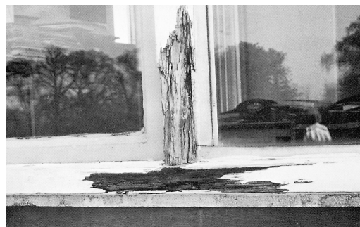
En este caso, se trata de una pudrición debida a la humedad retenida en la madera por agua infiltrada por las deficiencias de la pintura como consecuencia de un mantenimiento inexistente.
