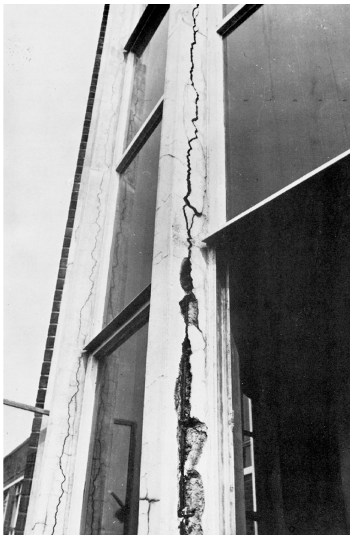
El proceso es claro, carbonatación del hormigón, corrosión y expansión del acero, y rotura final del hormigón.
