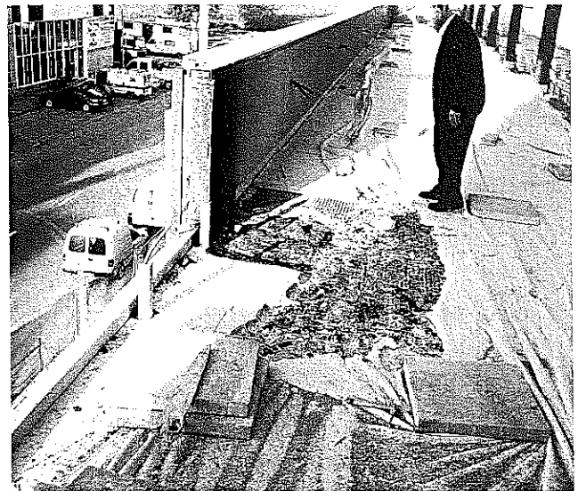
Figura 2.14. Incendio accidental en una cubierta durante el proceso constructivo
