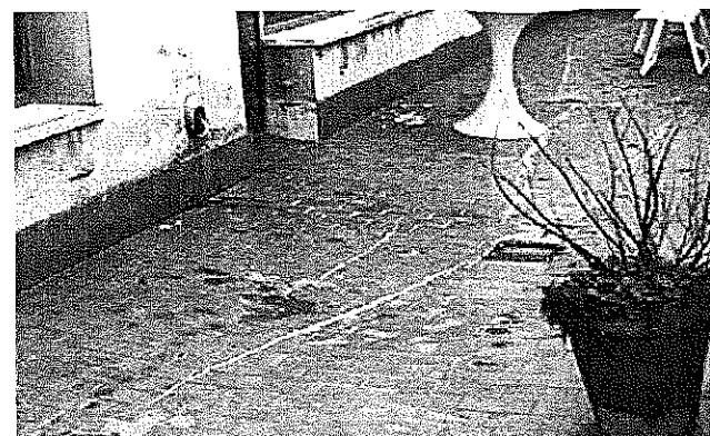
Figura 7.28. Lesiones de la capa de protección. Grietas por inexistencia de juntas
