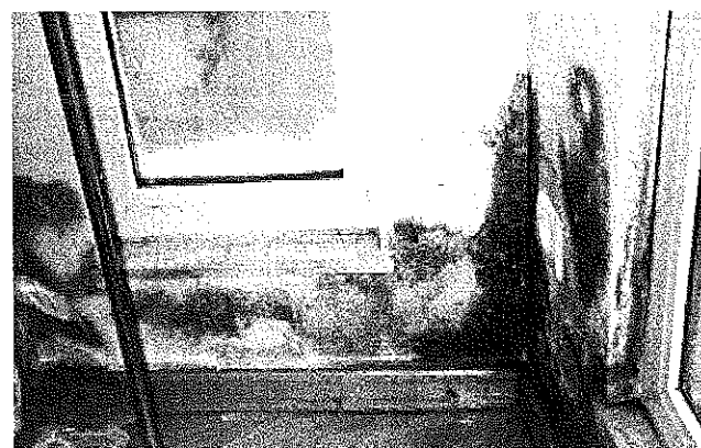
Figura 1.6. Humedades de condensación
