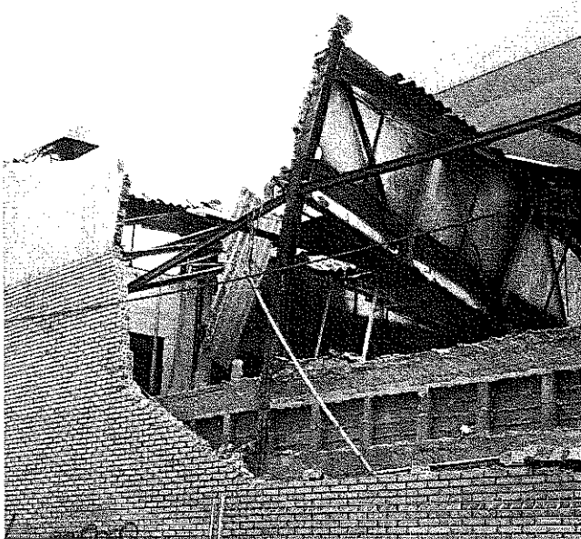
Figura 1.18. Efecto del fuego sobre una estructura de acero
