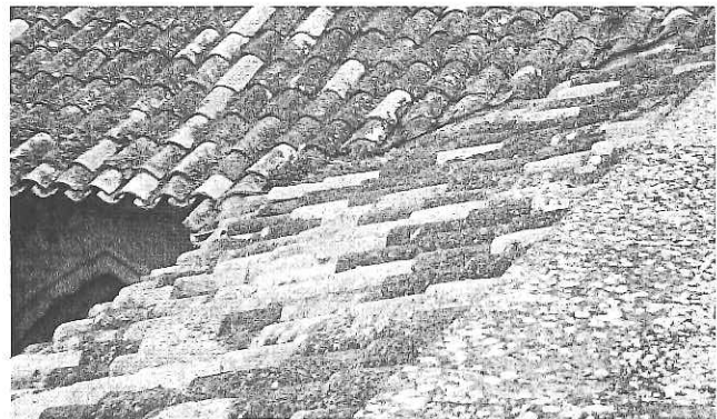
Figura 7.55. Lesiones de la cobertura. Presencia de gramíneas, cuyas raíces mueven la cobertura e impiden la adecuada evacuación del agua
