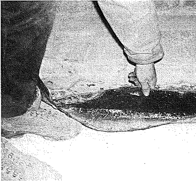
Figura 7.20. Lesiones de la impermeabilización. Solapes sin cerrar entre las láminas de la membrana
