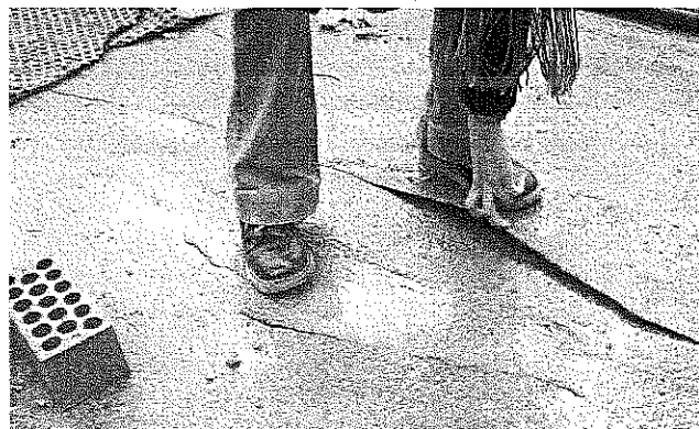
Figura 7.18. Lesiones de la impermeabilización. Roturas de la impermeabilización
