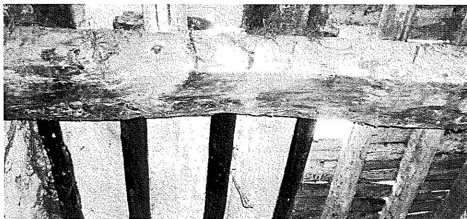
Figura 7.45. Lesiones de los soportes de cobertura. Roturas
