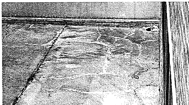
Figura 7.26. Lesiones de la capa de protección. Heladicidad
