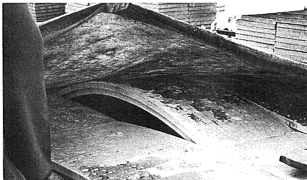
Figura 7.23. Abarquillamiento del aislamiento térmico por deficiencias en la espumación
