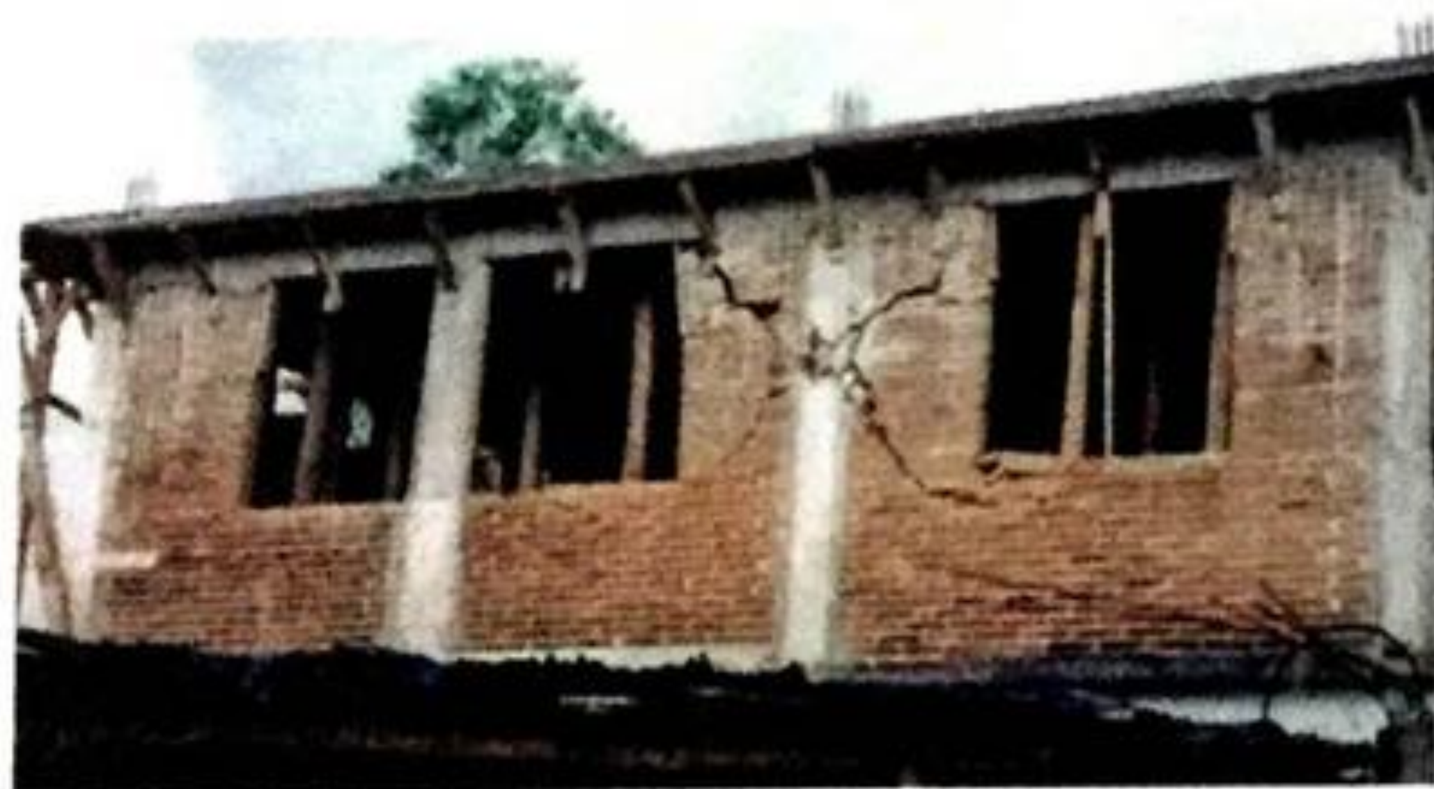
Figura 3.28 Daño en un segmento de muro no confinado (Alcocer S.).
