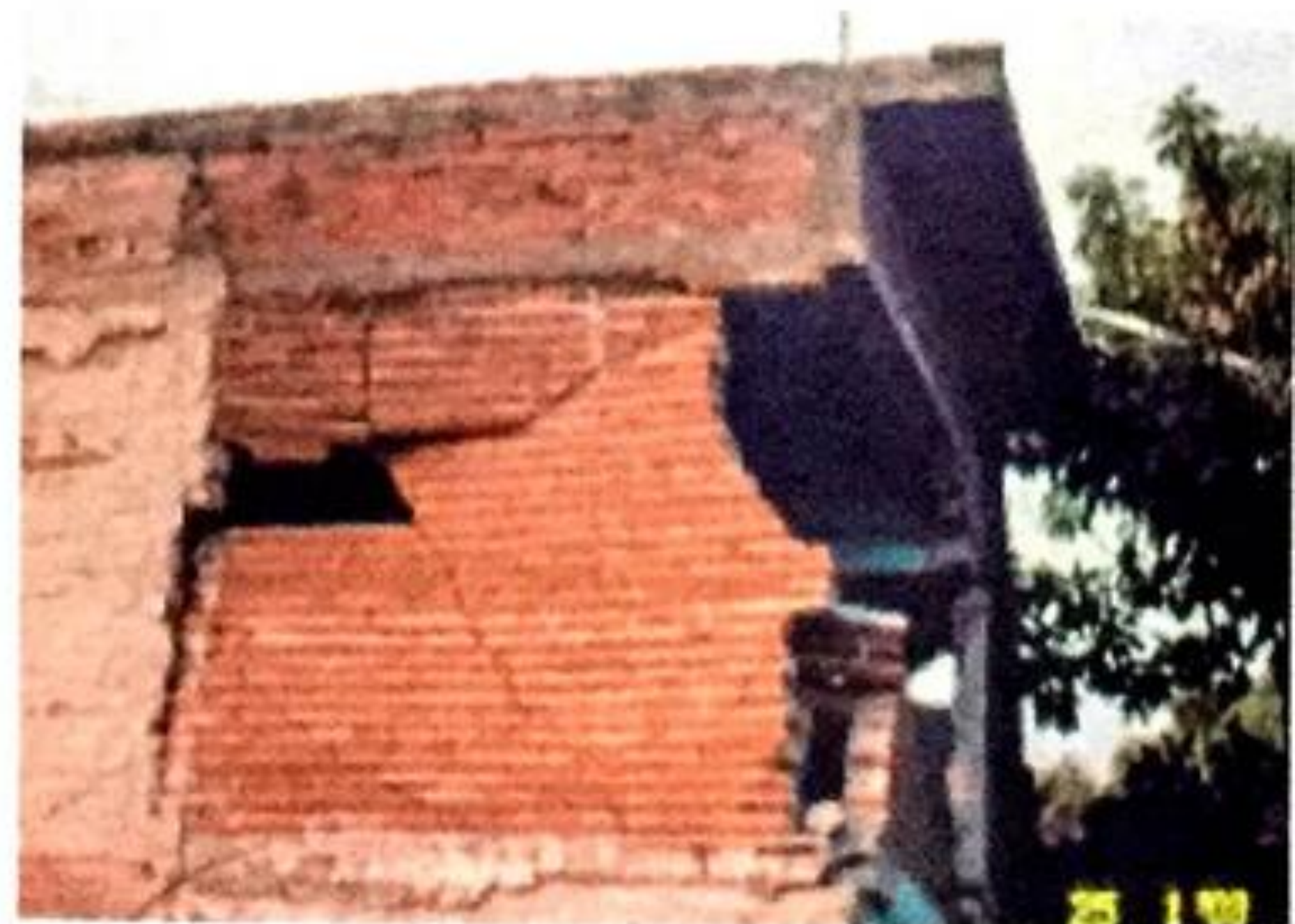
Figura 3.14 Daño en muros de mampostería sin refuerzo a consecuencia del sismo de Tecomán (SMIS y EERI, 2006).
