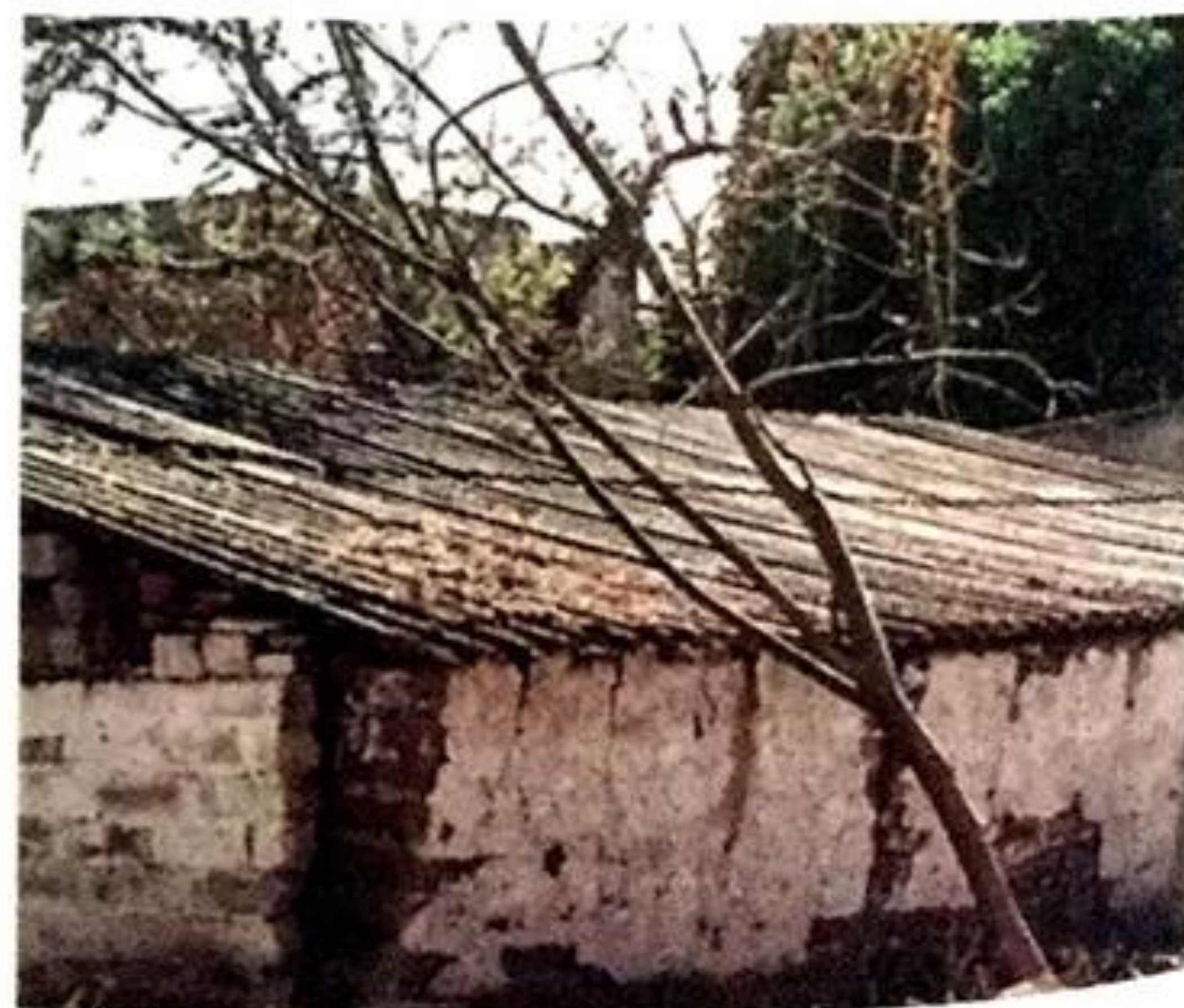
Figura 9.7 Daño por falta de castillo y dala.
