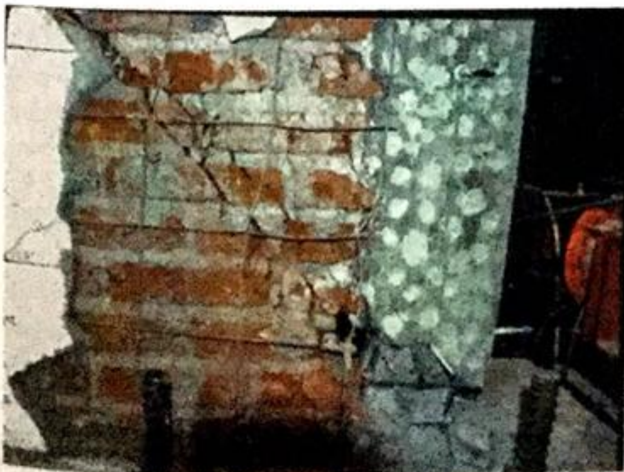
Figura 10.31 Daño en un castillo no confinado por la malla del encamisado.
