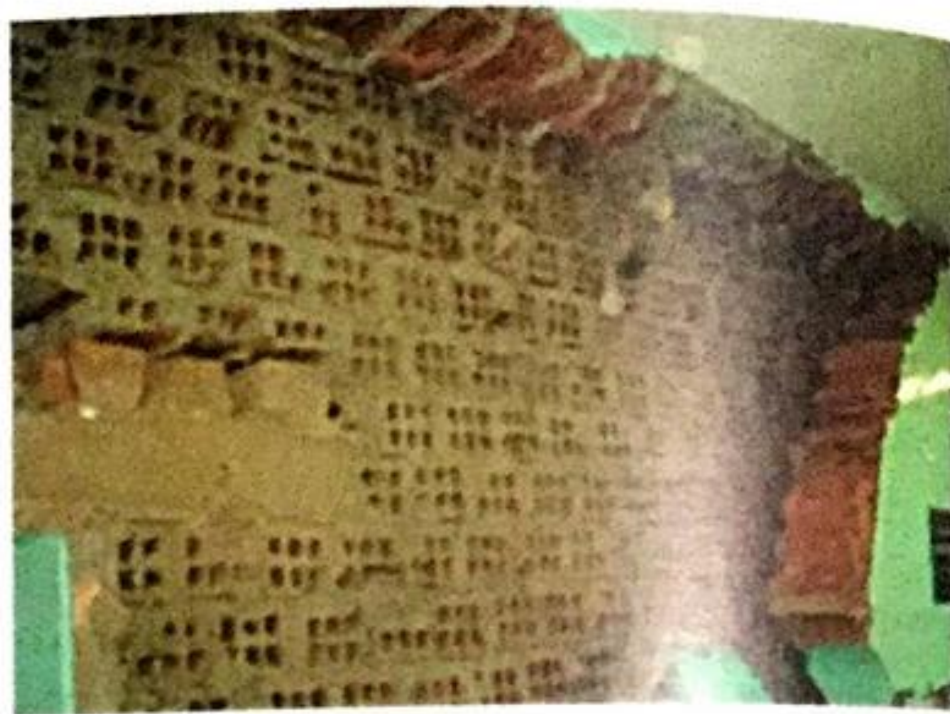
Figura 13.5 Fallas en muros de ladrillos pandereta.
