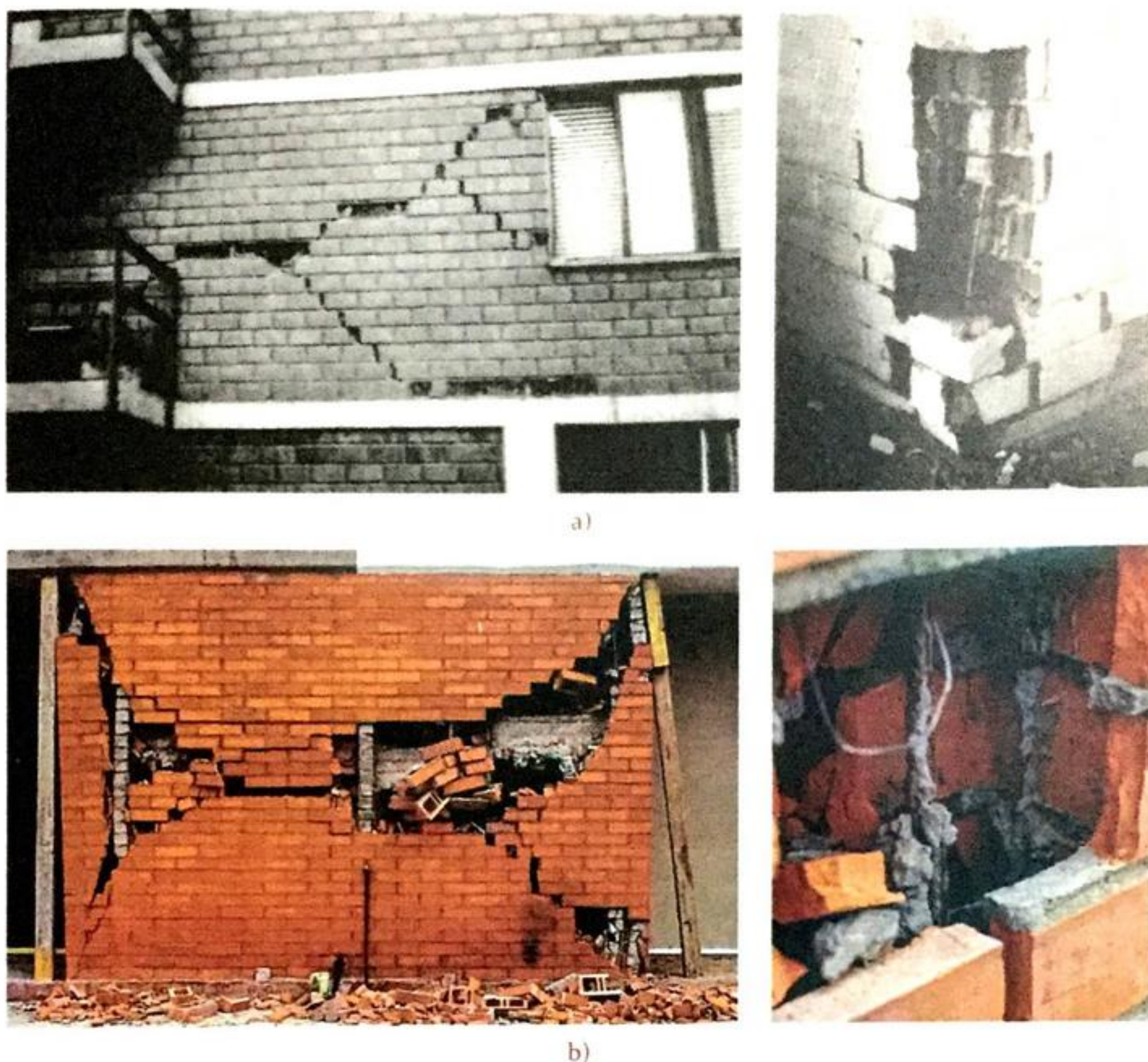
Figura 3.29 a) Daño en muros de mampostería con refuerzo interior (Schultz A., 1994); b) fallas en muros de mampostería con refuerzo interior deficiente (Alcocer y otros, 1999).
