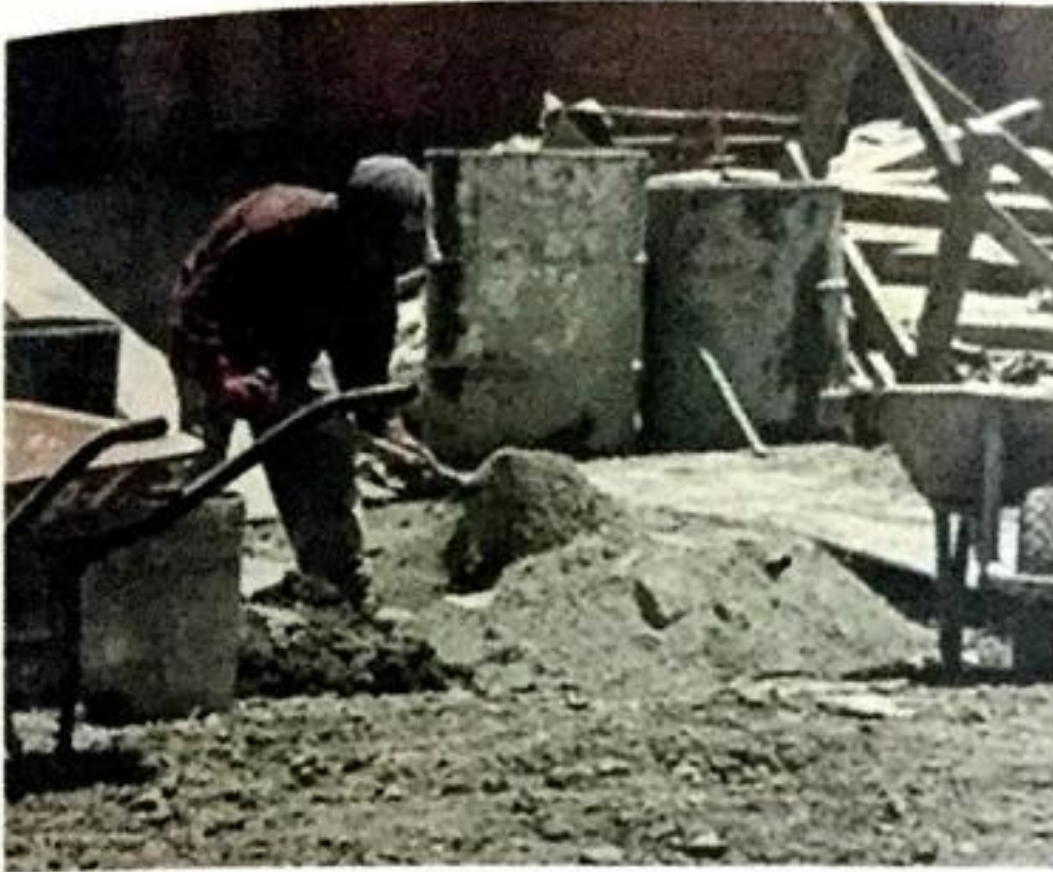
Figura 9.29 Superficie inadecuada para preparar mortero.
