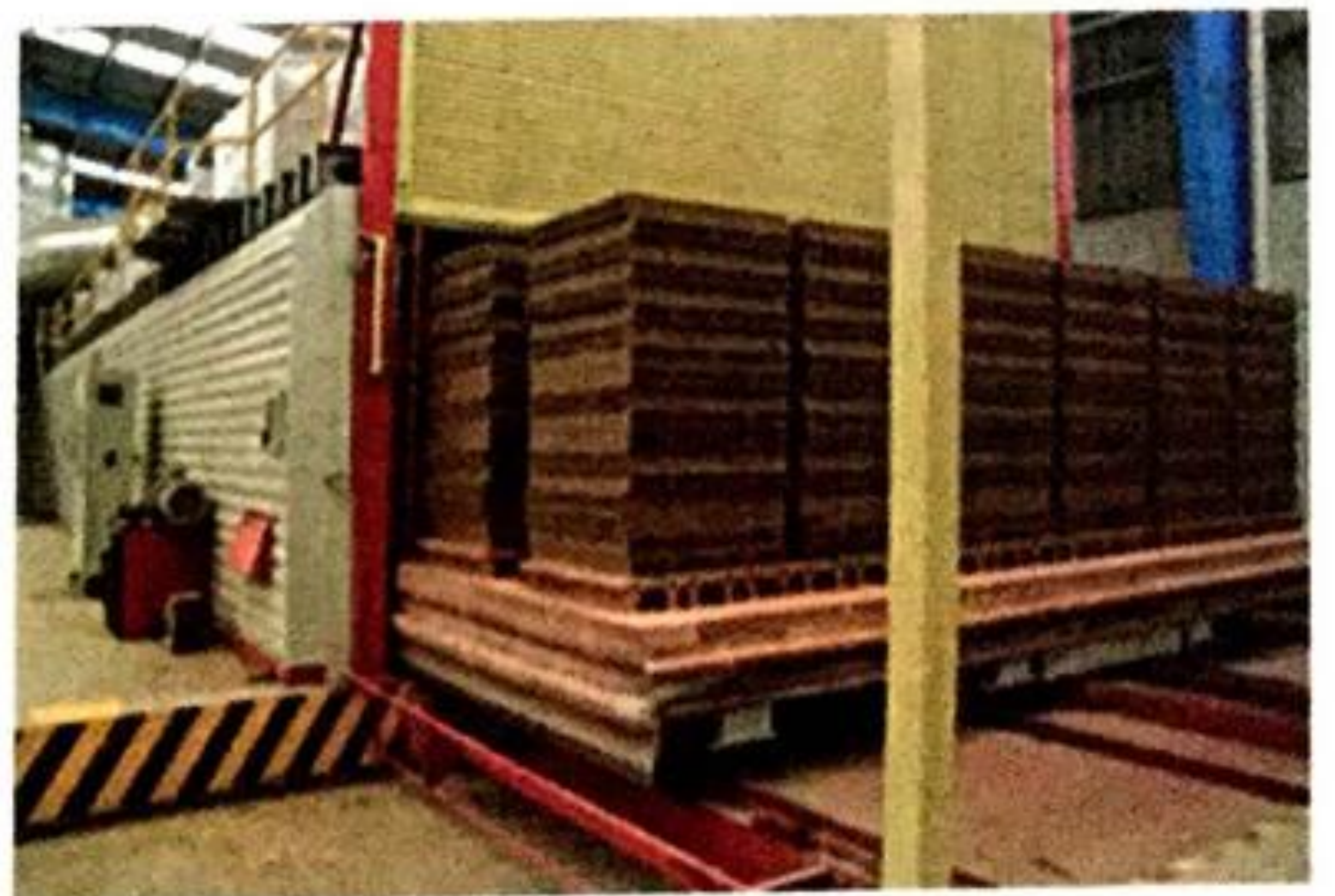
Figura 2.16 Zona de entrada al horno.
