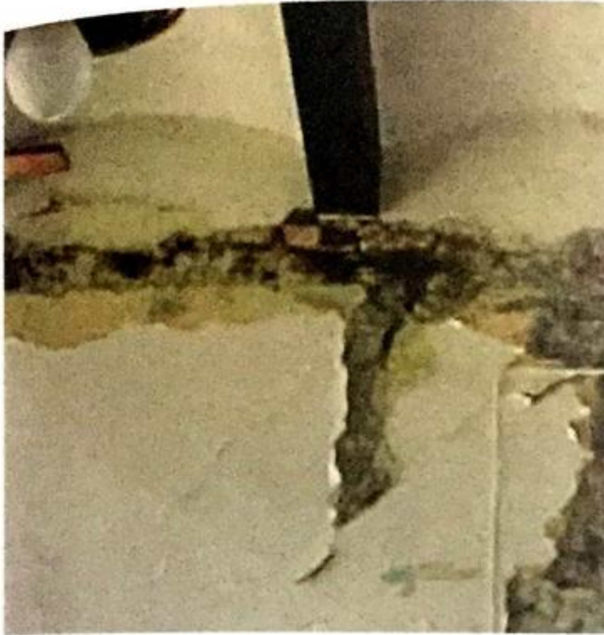
Figura 9.8 Daño provocado por la concentración de carga de una trabe ante la falta de una dala.
