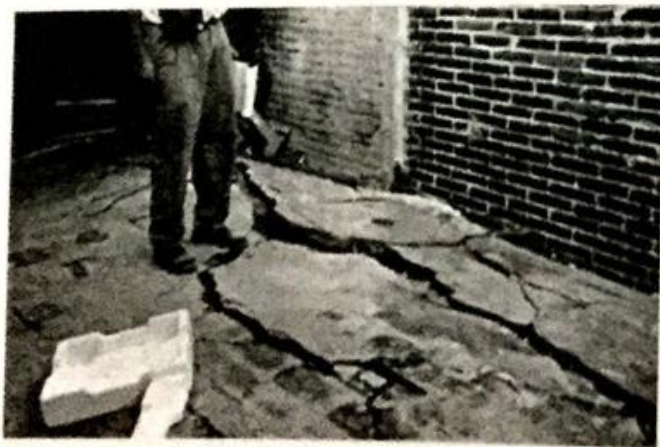
Figura 3.24 Asentamiento debido al fenómeno de licuación de arenas (López Bátiz & Teshigawara, 1997).
