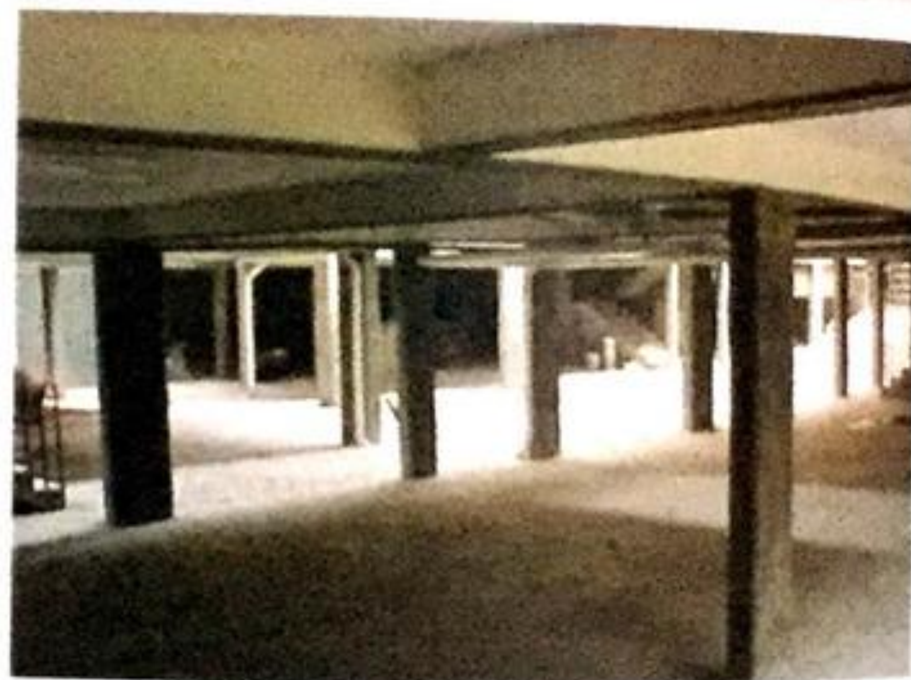
Figura 4.16 Ejemplo de columnas cortas en semisótano aunado a un entrepiso blando (Jean R.)
