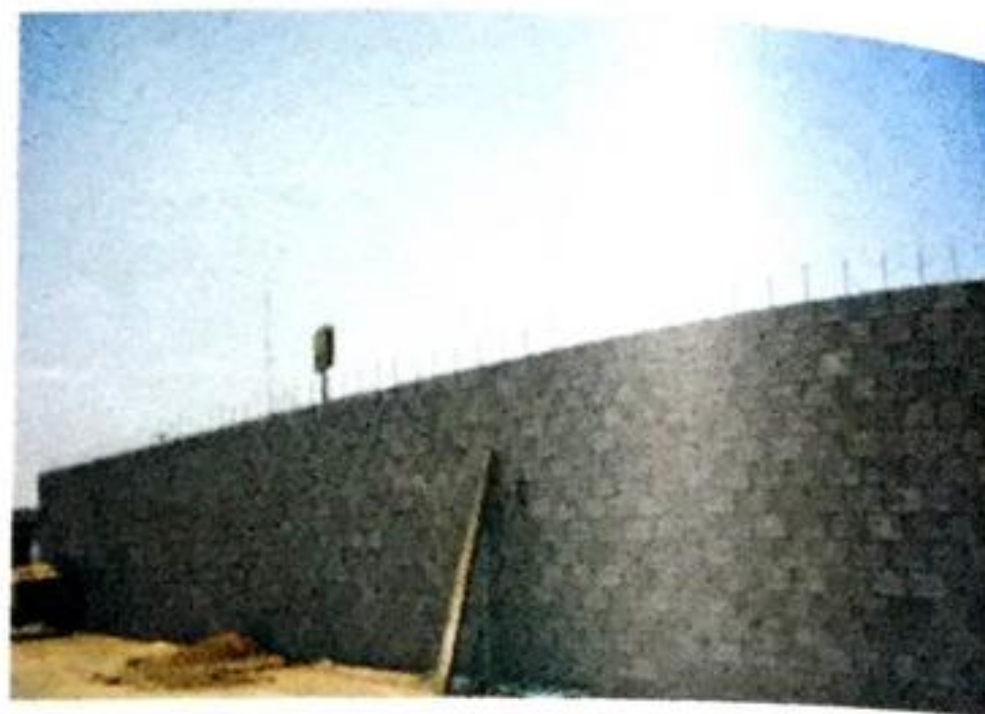
Figura 9.32 Ejemplo de muro expuesto que debe ser apuntalado. En este caso, es insuficiente.
