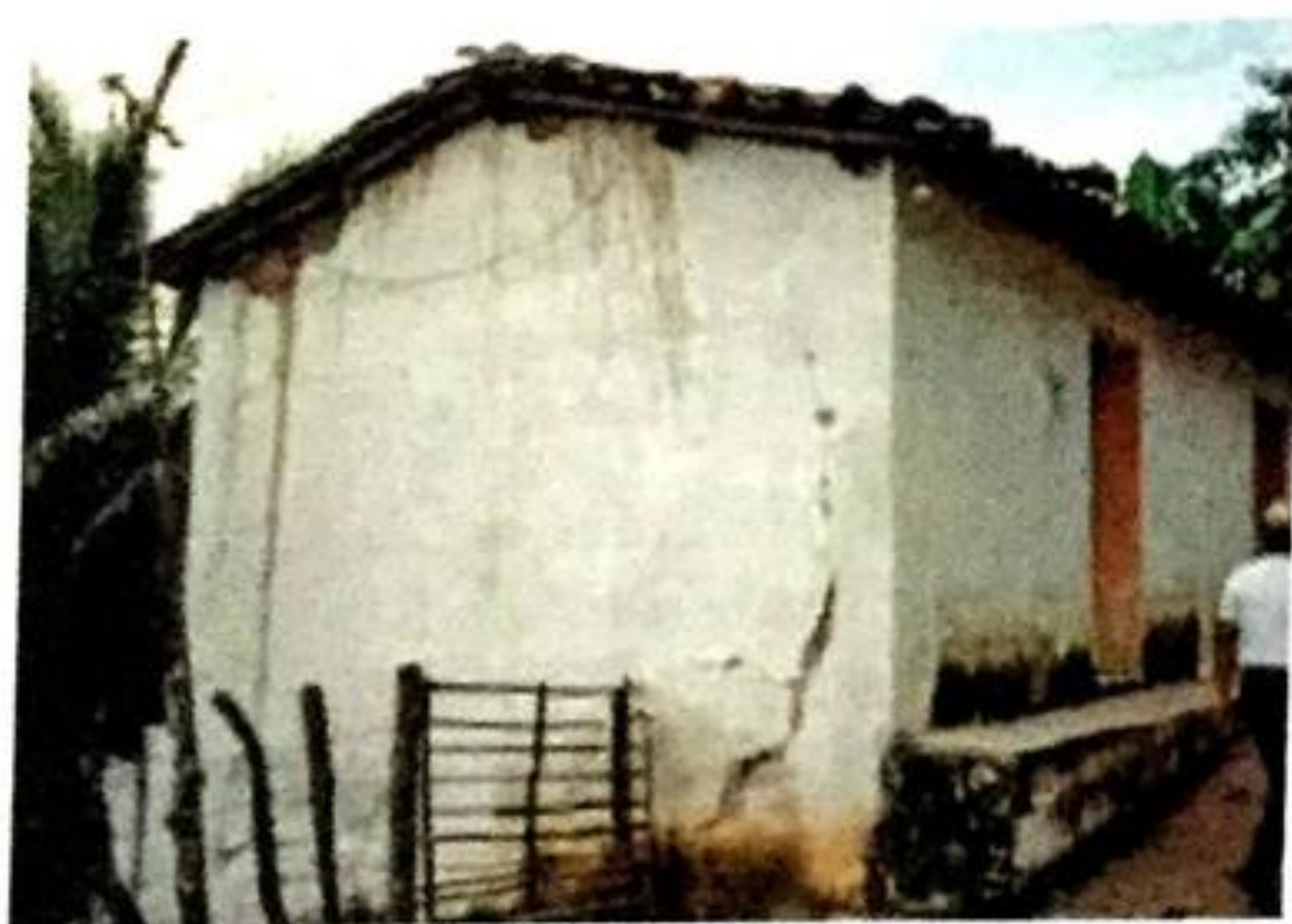
c) Humedad en techo y base de muro
