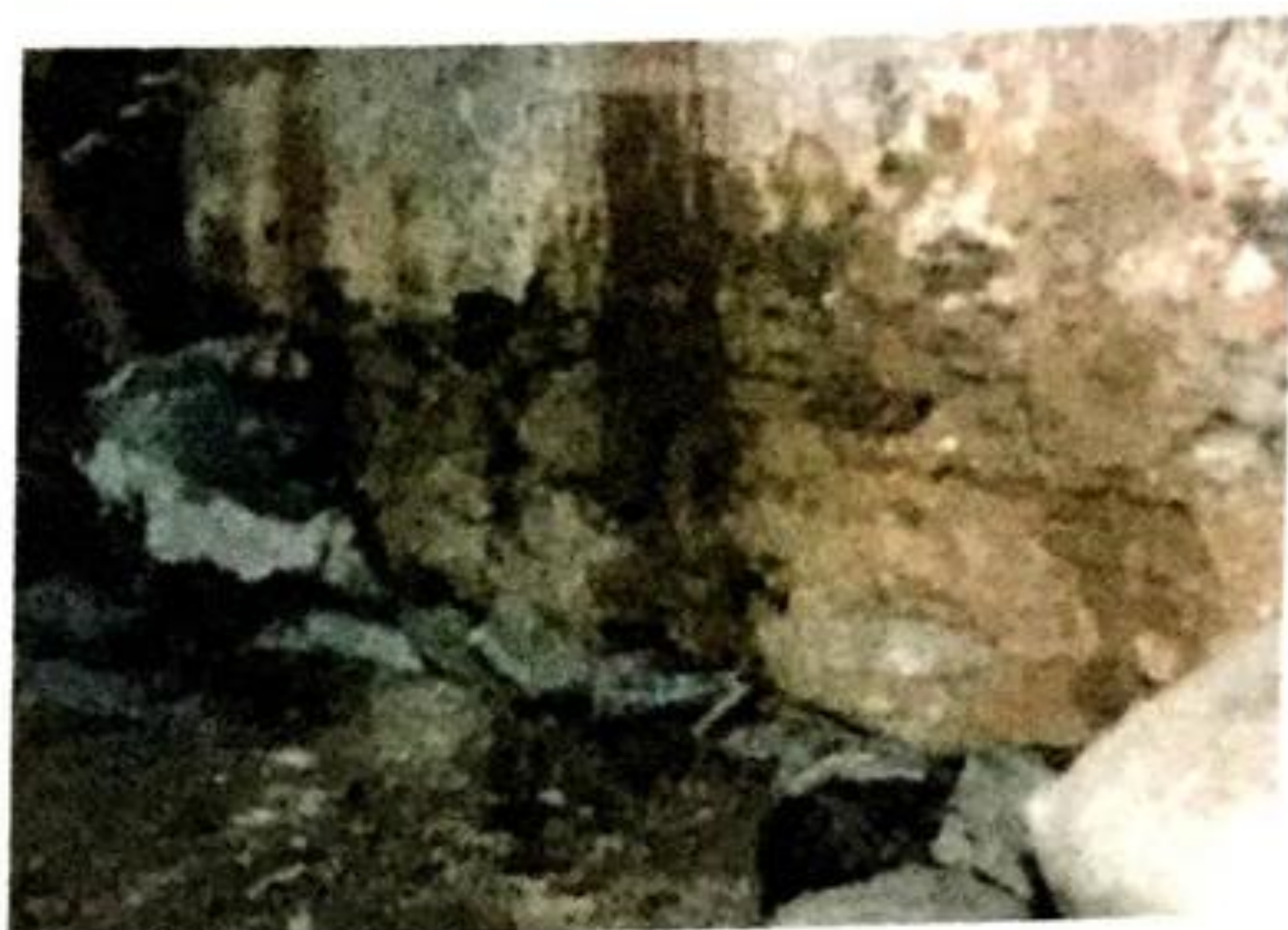
a) Socavación en la base de muro
