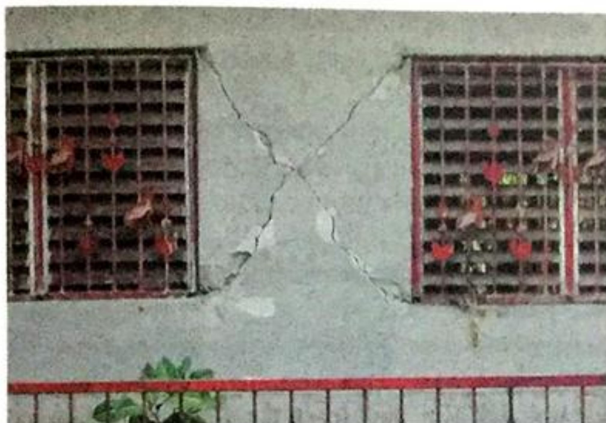
Figura 3.15 Agrietamiento en "X" en un segmento de muro entre ventanas (Alcocer Martínez de Castro y otros, 2003).
