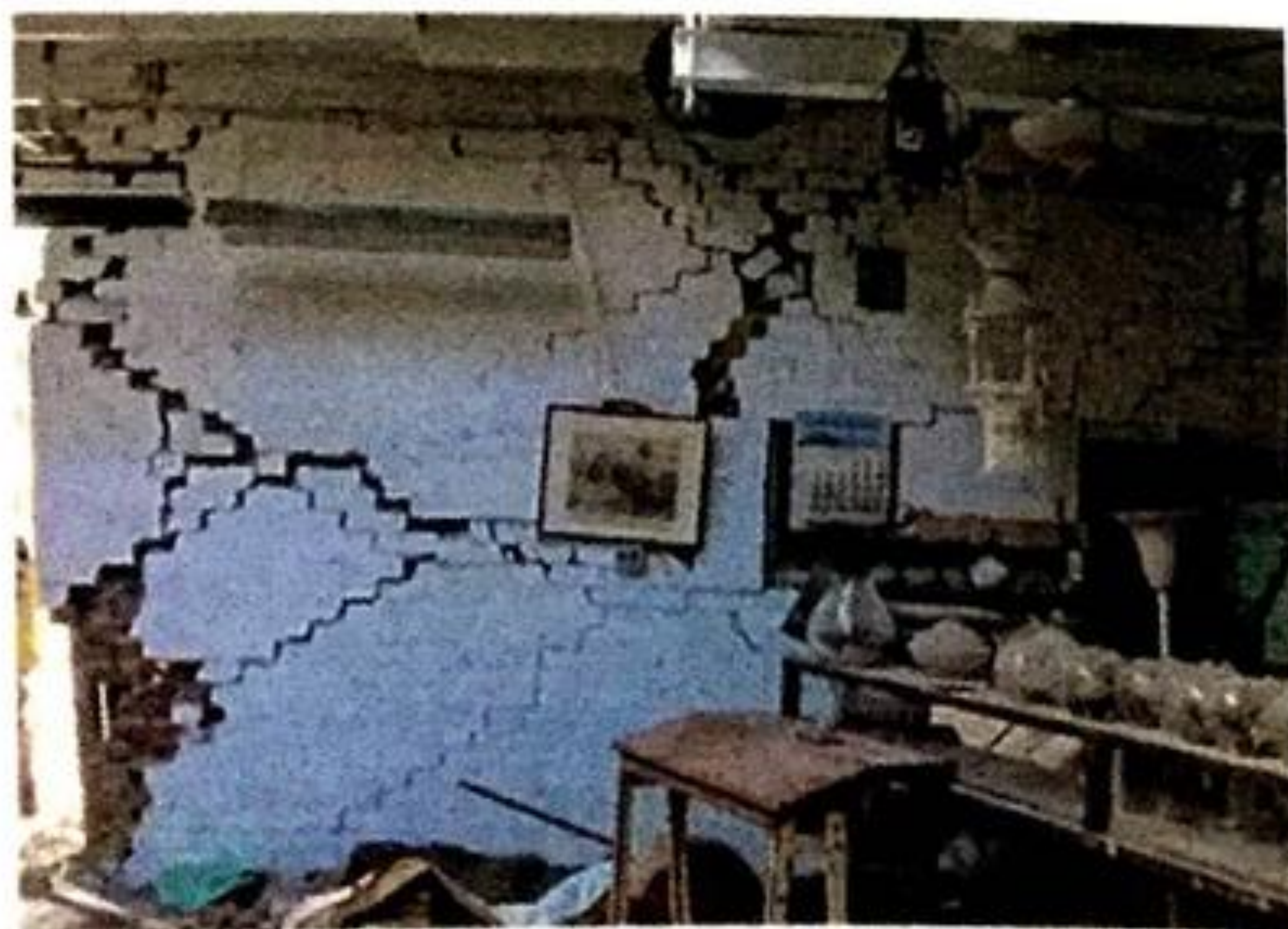
Figura 3.19 Falla de tensión diagonal en muro de mampostería no reforzada (Dizhur y otros, 2011).
