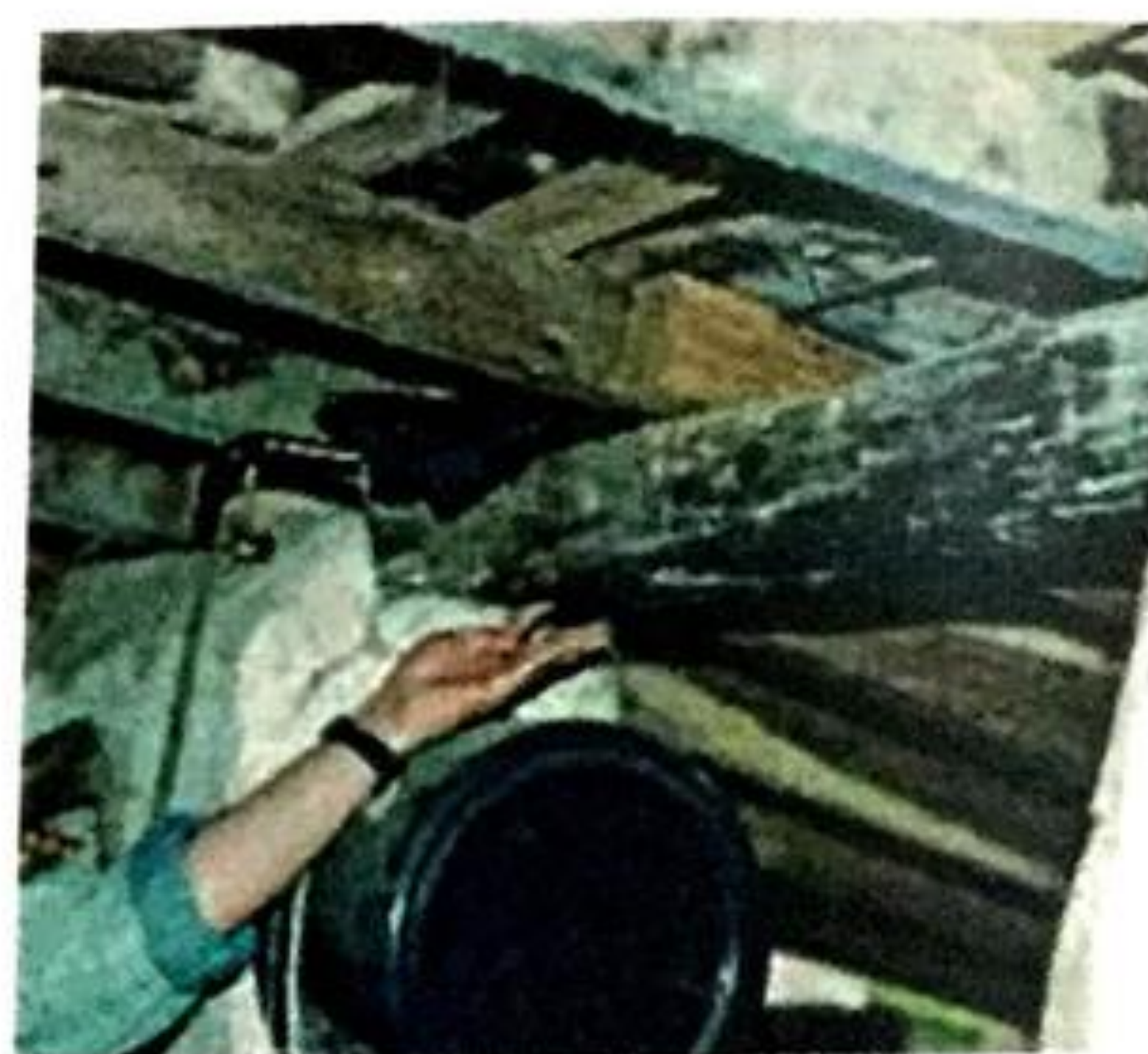
d) Techo debilitado por humedad
