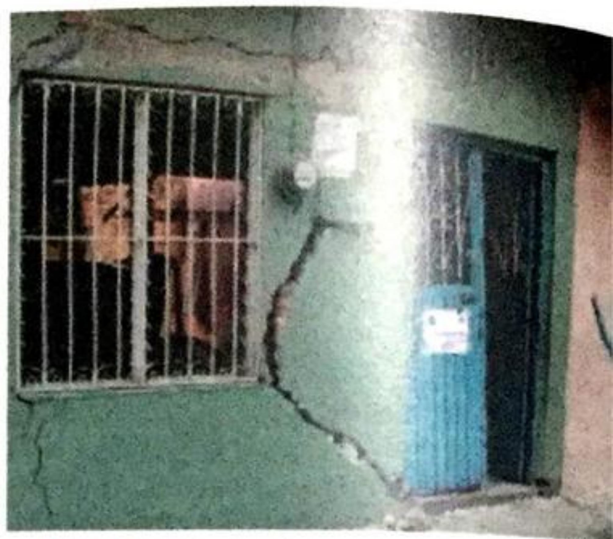
Figura 3.13 Agrietamiento inclinado en muros de mampostería sin refuerzo a consecuencia del sismo de Tecomán (SMIS y EERI, 2006).
