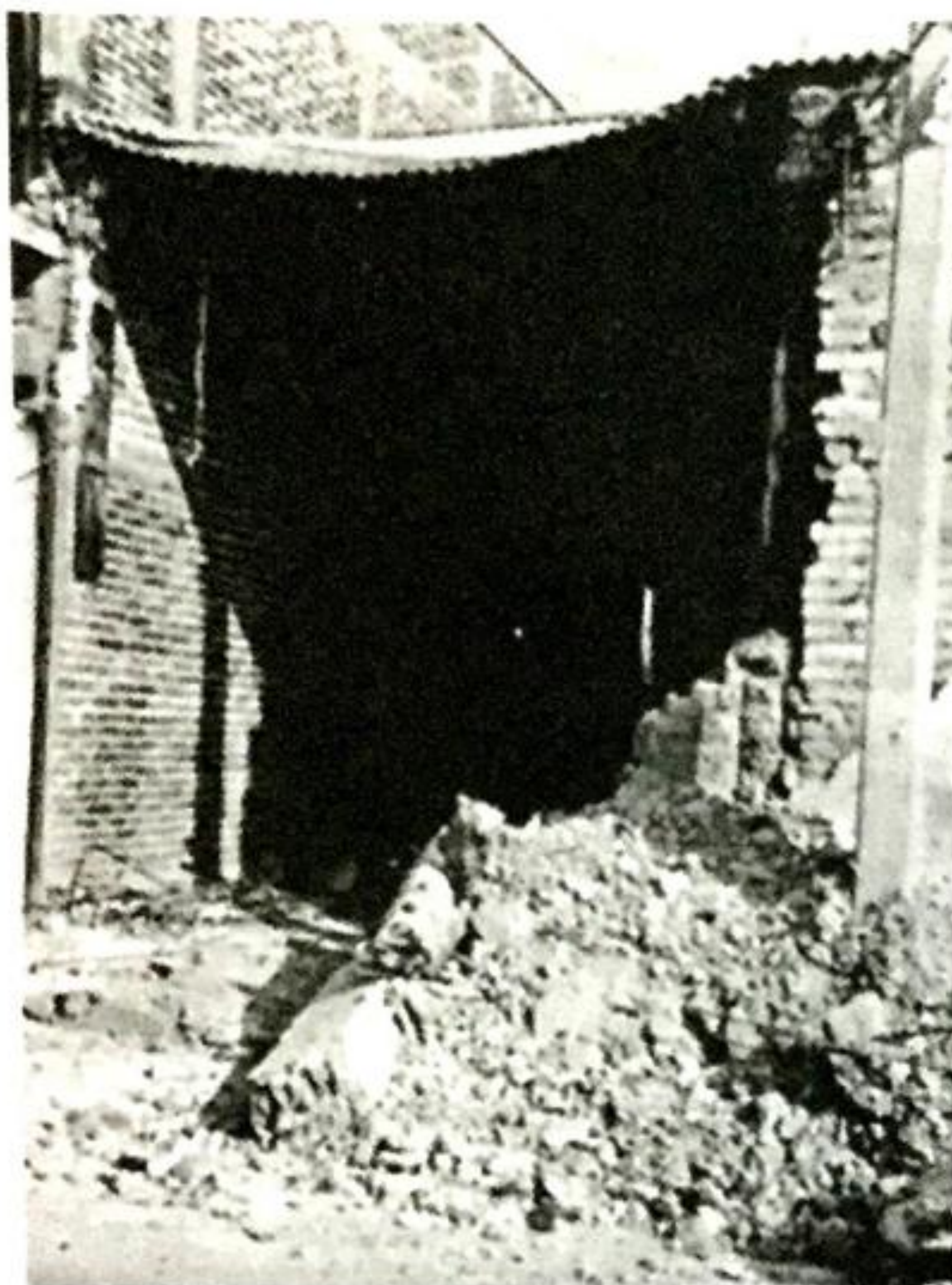
Figura 3.12 Inadecuada conexión de muros de mampostería con elementos confinantes (López Bátiz & Teshigawara, 1997).
