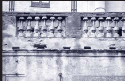
Balastrada y sus imbornales sobre la solera cerámica en la calle Sots-Tinent Navarro, 28 de Barcelona (1846) [Foto Jaume Rosell]
