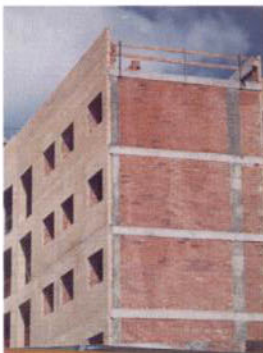
Criterios confusos en la construcción actual.
