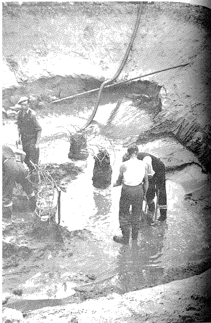
Figura 9.5. Hundimiento de las pendientes excavadas bajo el nivel freático en arena fina, Port Talbot, Gales del Sur.
