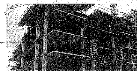
EDIFICIO CON ENTREPISOS SIN VIGA
